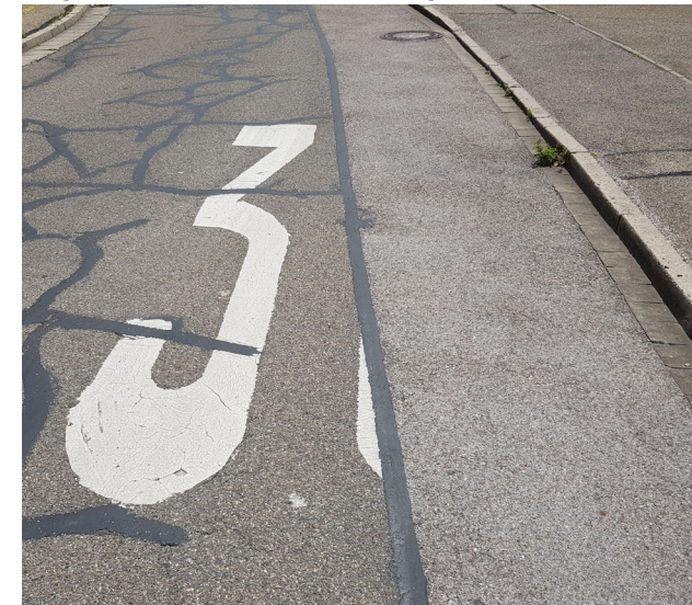
- verblasste Kennzeichnung der Geschwindigkeitsbegrenzung mit schlechtem Oberflächenbelag
